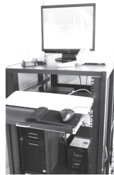
事務所内設置のサーバー
